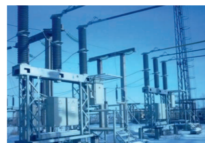
▶ Подстанция Степногорск, ОРУ 110 кВ с ВРС-110, Казахстан
