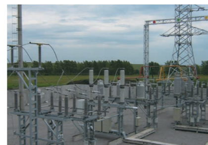
▶ Подстанция 110/35/6 кВ Вольная, Россия
