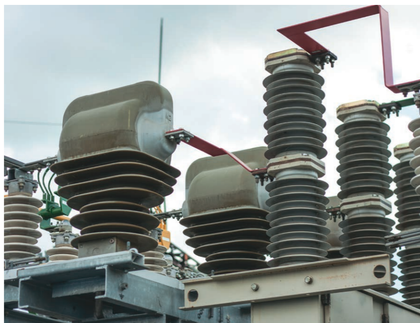
Блок ОРУ 35 кВ тяговой подстанции
