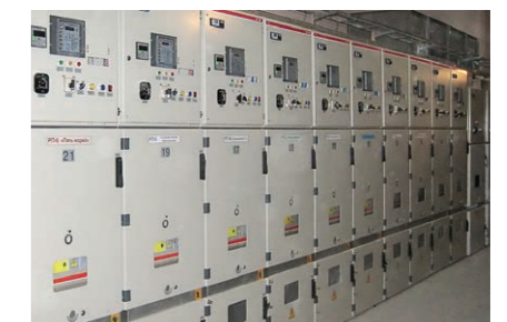
▶ РУ 10 кВ подстанции Р-22
