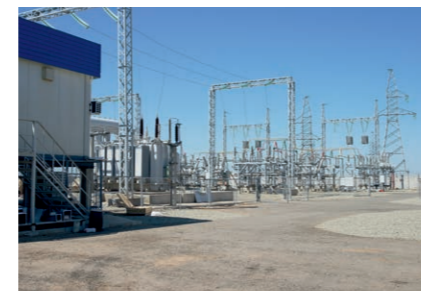
▶ Подстанция 110/35/10 кВ НПС-2, Ф-л ОАО «МРСК Юга» – «Налэнерго», Россия
