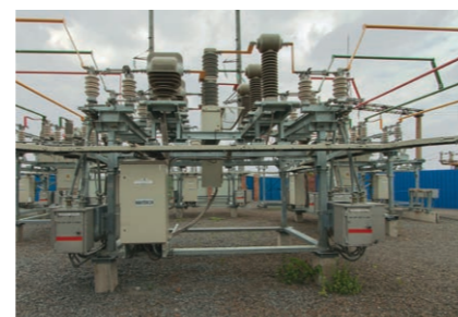
▶ Подстанция 35 кВ Дузино-1, Россия
