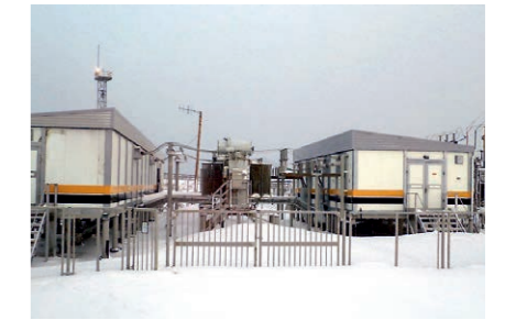
▶ Подстанция 35/10 кВ Северный куст, ООО «РН-Сахалинморнефтегаз», Россия
