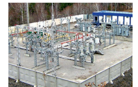
▶ Подстанция 110/10 кВ Фланговый ствол, ОАО «СУЭК», Россия
