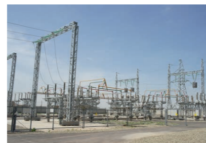
▶ Комплектная трансформаторная подстанция КТПБР-110/35/6(10) кВ
