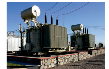
▶ Подстанция 110/35/10 кВ Полиэтилен, Министерство энергетики, Туркменистан
