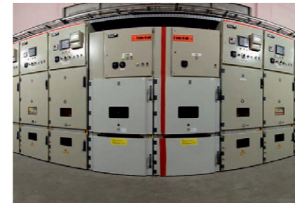
▶ Подстанция 110/35/10 кВ Р-22, ЗРУ 10 кВ, Ф-л ОАО «МРСК Юга» – «Ростовэнерго», Россия
