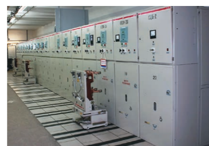
▶ Ячейки КУ-10Ц, установленные в подземном РУ 10 кВ
