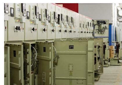
▶ Подземное РУ 10 кВ тяговой подстанции метрополитена
