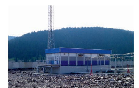
▶ Подстанция Межегей, КРПЗ-10, ООО «УК «Межегейуголь», Республика Тыва
