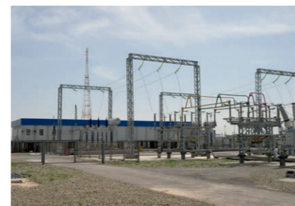
▶ Комплектная трансформаторная подстанция КТПБР-110/35/6(10) кВ
