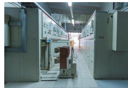
▶ Подстанция Р8, ЗРУ 6 кВ, Ф-л ОАО «МРСК Юга» – «Ростовэнерго», Россия
