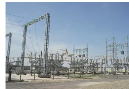
▶ Комплектная трансформаторная подстанция КТПБР-110/35/6(10) кВ
