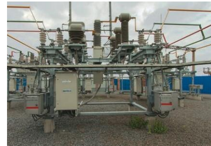
▶ Подстанция 35 кВ Дугино-1, Россия
