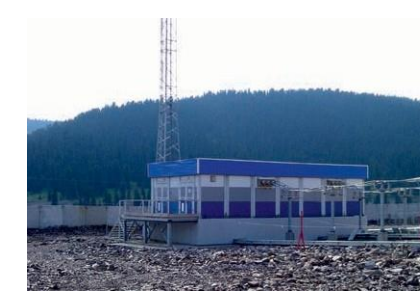
▶ Подстанция Межегей, КРПЗ-10, ООО «УК «Межегейуголь», Республика Тыва
