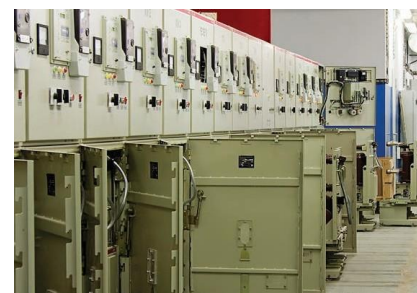
Подземное РУ 10 кВ тяговой подстанции метрополитена
