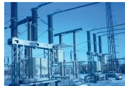
▶ Подстанция Степногорск, ОРУ 110 кВ с ВРС-110, Казахстан
