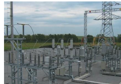
▶ Подстанция 110/35/6 кВ Вольная, Россия
