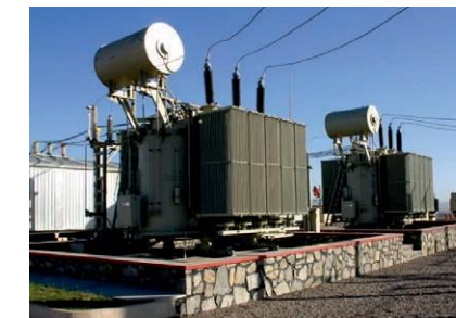
▶ Подстанция 110/35/10 кВ Полиэтилен, Министерство энергетики, Туркменистан
