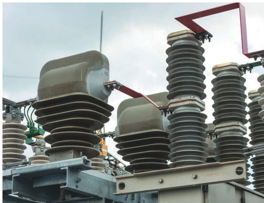
Блок ОРУ 35 кВ тяговой подстанции
