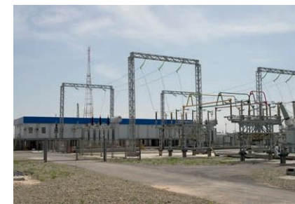
▶ Комплектная трансформаторная подстанция КТПБР-110/35/6(10) кВ
