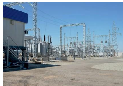
▶ Подстанция 110/35/10 кВ НПС-2, Ф-л ОАО «МРСК Юга» – «Калмэнерго», Россия
