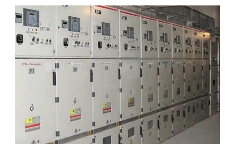
▶ РУ 10 кВ подстанции Р-22
