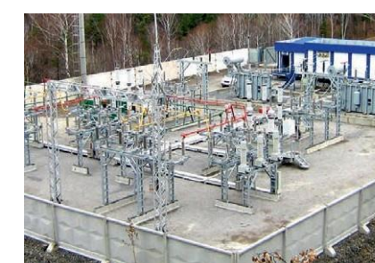
▶ Подстанция 110/10 кВ Фланговый ствол, ОАО «СУЭК», Россия
