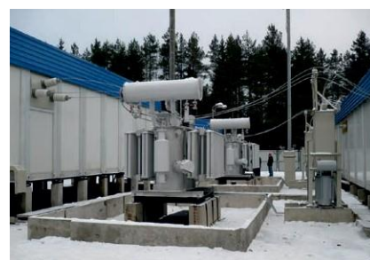
▶ Подстанция 35/10 кВ Ящерово, Ф-л ОАО «МРСК Северо-Запада» – «Новгородэнерго», Россия
