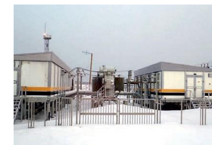
▶ Подстанция 35/10 кВ Северный куст, ООО «РН-Сахалинморнефтегаз», Россия
