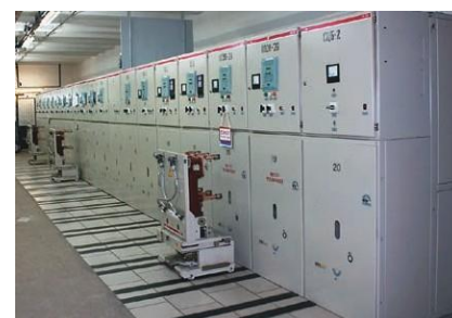
▶ Ячейки КУ-10Ц, установленные в подземном РУ 10 кВ
